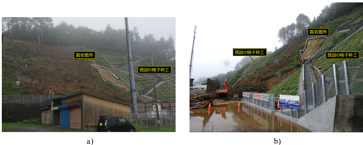
図 3.22 格子枠工施工箇所における被災箇所の状況
