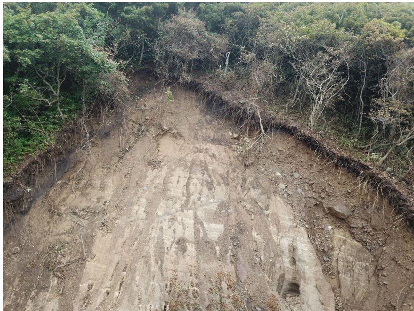
図 3.24 斜面崩壊②における滑落崖の状況
