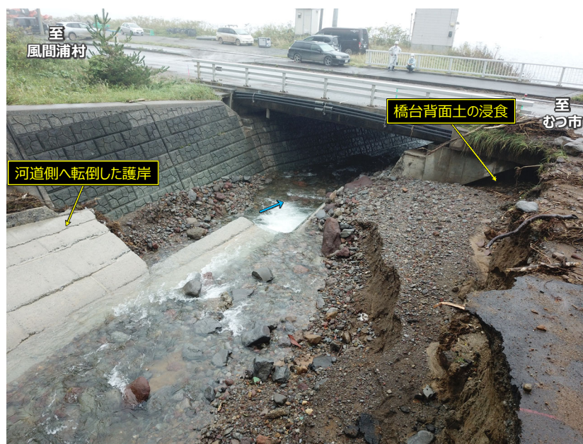
図 3.3 上流から撮影した被災状況
