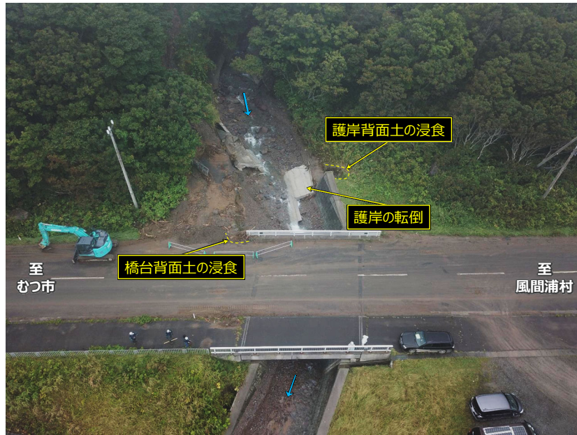
図 3.2 下流から撮影した被災状況
