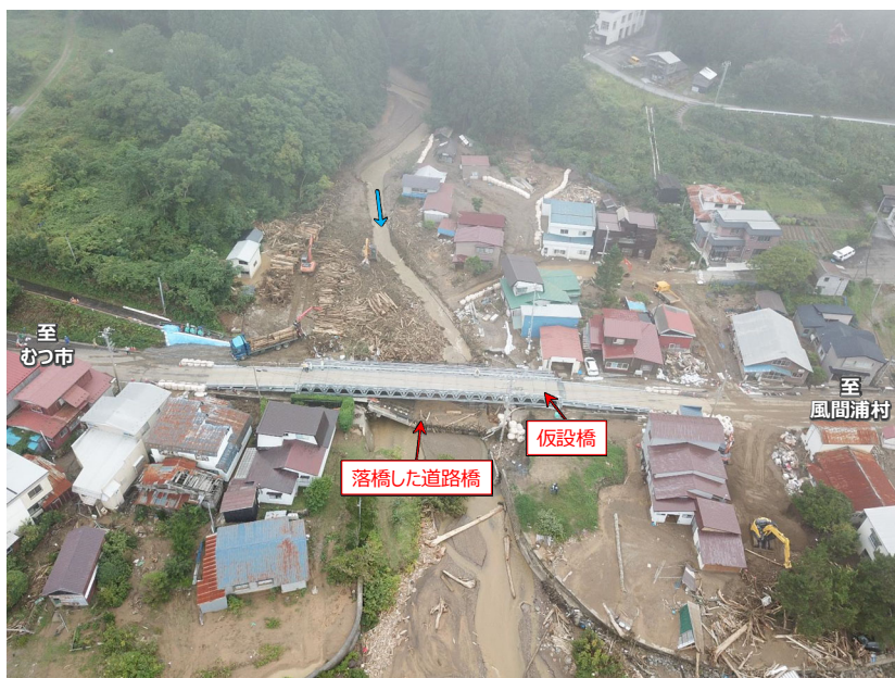
図 3.7 下流から撮影した被災状況
