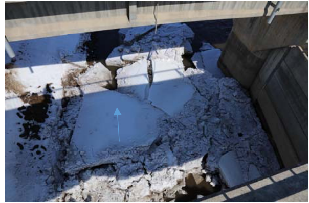
大正橋下流 (橋から撮影) 橋脚箇所で河水堆積
