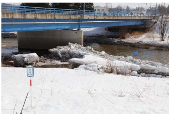
橋脚部で河水の堆積 (左岸から撮影)
