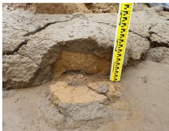
図 3.3 舗装面上の堆積物の状況
