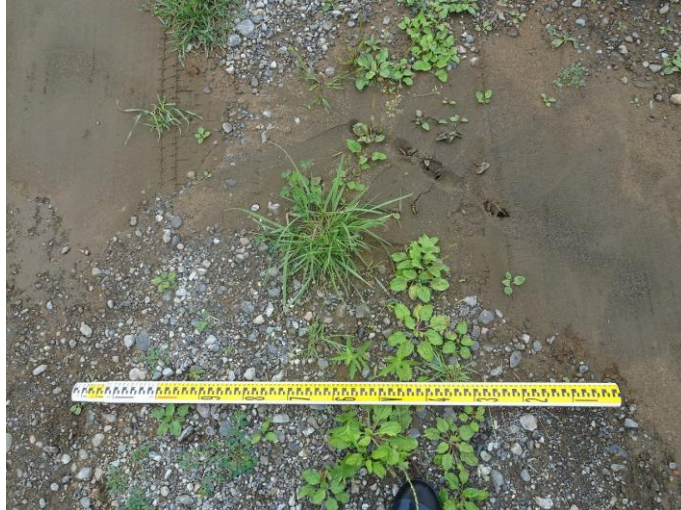
図 5.2e) 堤外地盤での噴砂 (KP2.7 付近)
