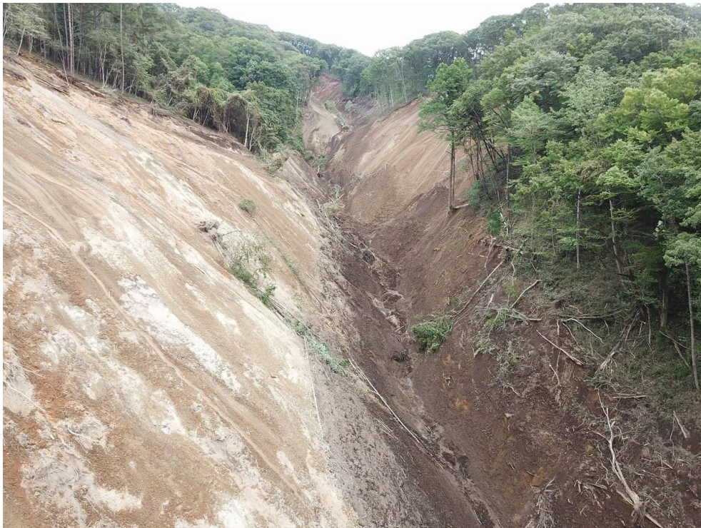
図 4.4c) 図 4.3 中の c)付近からの崩壊状況
