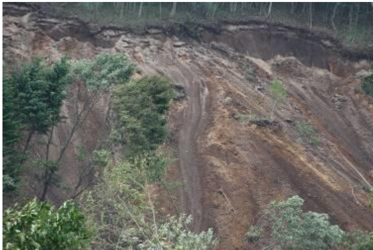
図 4.2c) 崩壊面の状況
