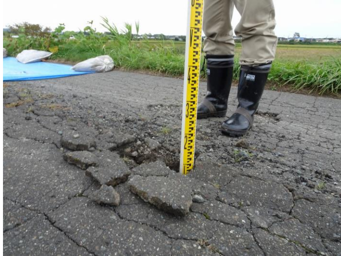
図 5.2b) 地震によって拡大したと予想される亀裂の状況
