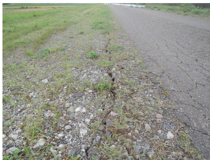
図 5.2a) 側帯盛土と本堤の境界部での亀裂の状況
